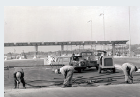
1967年 東名高速道路名古屋 インターでのカットオフ ジョイント新設工事
