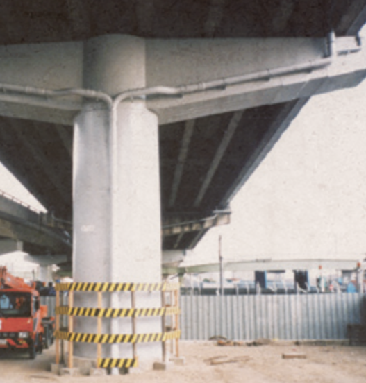
震災直前に完成した橋脚補強箇所には被害はなかった
