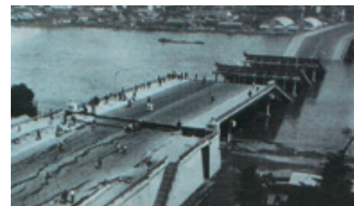
1964年 新潟地震で被災した昭和大橋
