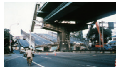
1995年 落橋した阪神高速道路の高架橋
