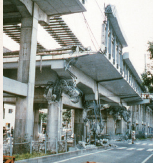
落橋した新幹線高架橋（山陽新幹線）
