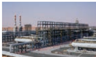
アブダビ陸上鉱区(原油処理施設)
