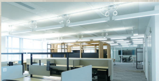
きめ細かく制御された照明システム
