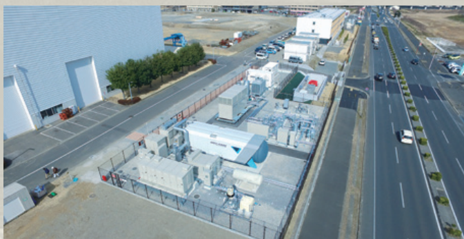
先進的なコージェネプラントの設備群
