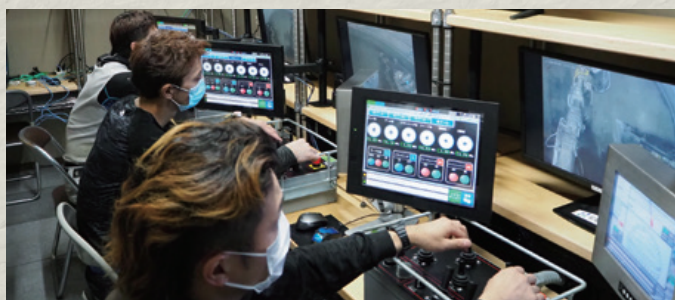
遠隔操作 (中央制御室)
