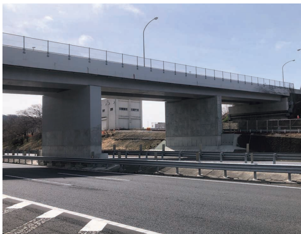
工事名：東北自動車道 極瀬第一橋（ロッキング橋脚）耐震補強工事 発注者：東日本高速道路株式会社
