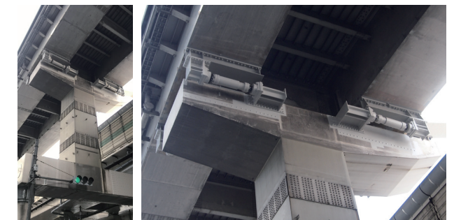
写真-6 摩擦ダンパーを設置した橋梁(11号台場線)
