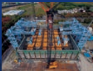
呑龍ポンプ場
