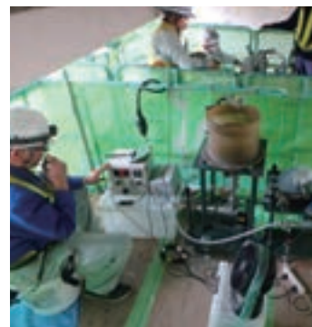
空洞推定状況
