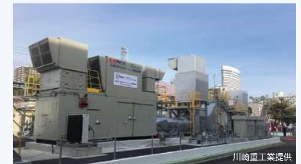
ドライ低NOx水素専焼ガスタービンの実証試験プラント NEDO助成事業
