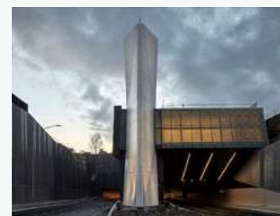
設置したトンネル換気塔。換気に伴う消費電力を抑え年間約4,600tのCO 2 排出量を削減
