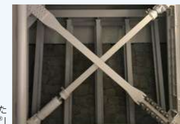
天守閣に設置された「クロスダンパー®」
