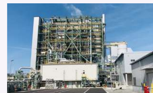
神栖バイオマス発電所の発電施設全景
