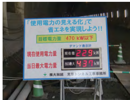
工事中のトンネルの入り口にデマンド表示計を設置。作業員一人ひとりの節電意識を高め、使用電力を削減
