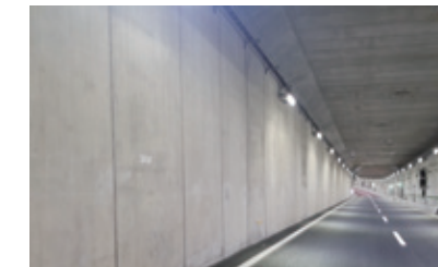
ハイブリッドハーフプレキャスト構造による大断面ボックスカルバートの省人化・省力化(東京外環自動車道 京葉ジャンクションAランプ)
