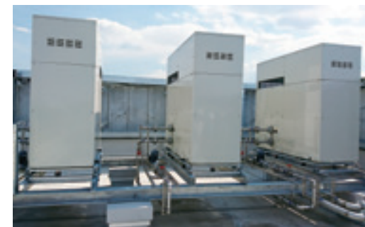
TMGあさか医療センター(埼玉県朝霞市) コージェネレーションシステムのエネルギーサービスで省エネルギーとBCP対応を実現
