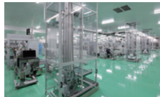
沢井製薬三田西工場 包装ライン設備 (兵庫県三田市) 最新鋭医薬品製造工場の生産設備・生産管理システム一式をEPC受注
