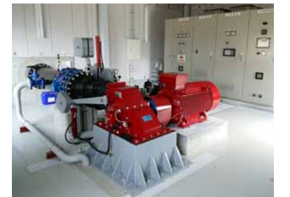
発電機 (クロスフロー水車)
