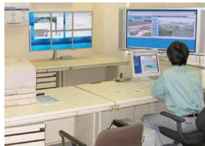
防災監視ルーム
