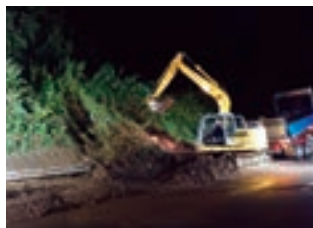
首都圏中央連絡自動車道での被災状況
