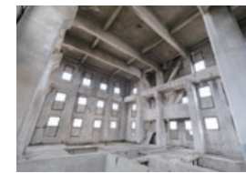
櫓の内部 ワイヤでかごをつり下げ、地下430mからエレベーターのように石炭と作業員を上げ下げした
