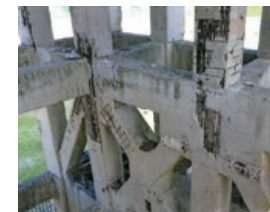
鉄筋コンクリート造りの櫓 建造から75年が経過し、劣化したコンクリートがはがれ中の鉄筋が露出
