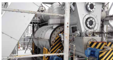
熱分解炉(外熱式水平ロータリーキルン)
