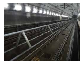
限界支障報知装置電飛工区(青函トンネル海底駅付近)
