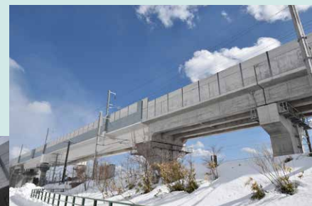
木古内橋りょう外8箇所(PCけた)他
