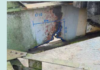
激しく腐食したトラスの横桁
