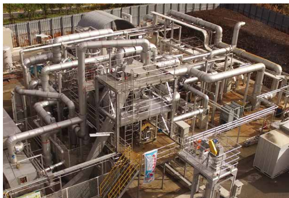
バイオマスガス発電プラント
