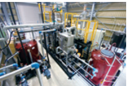
ガス化ユニット
