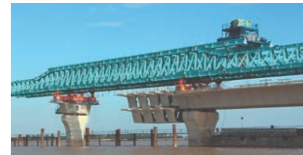
世界最大級のスパンバイスパン架設(ラックフェン橋/ベトナム)
