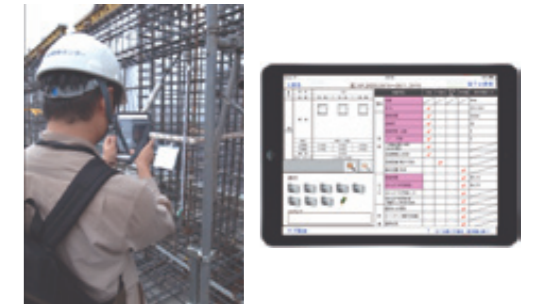
配筋検査、配筋写真撮影などの施工管理機能をタブレット端末に集約
