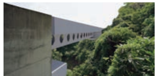
超高耐久橋梁の完成イメージ図 [提供：西日本高速道路(株)]
