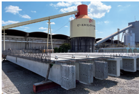
SLPCを採用したPC桁のプレキャスト工場での仮置き状況
