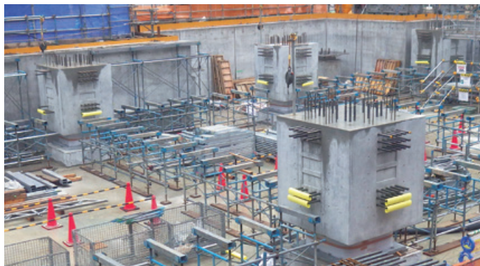
PCa部材が用いられた基礎部分の免震部材
