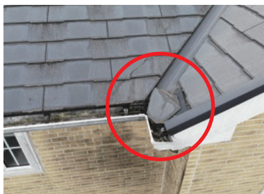
ドローンで発見した屋根の破損
