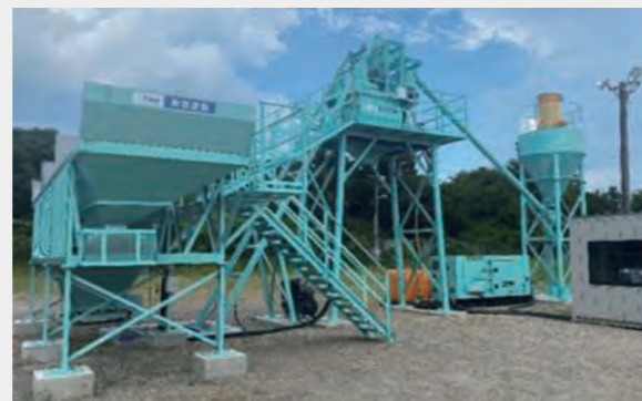
常温アスファルト混合物プラント
