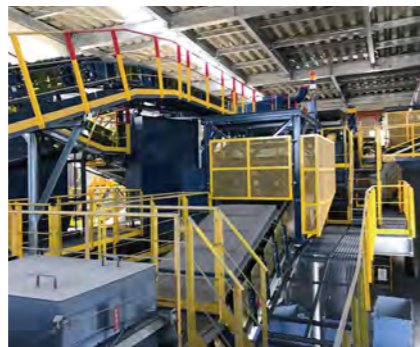
屋内型のリサイクル施設
