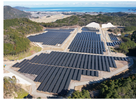
2023 年 6 月に竣工した延岡くじら池太陽光発電所
