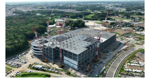
土木事業・関連事業と連携して推進してきた千葉県柏市の土地区画整理事業において、大型物流施設を建設
