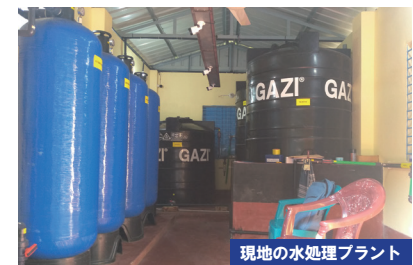
現地の水処理プラント
