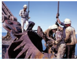
スエズ運河改修工事受注(1961) スエズ運河拡幅増深工事受注(1974)
