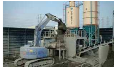
汚泥処理プラント
