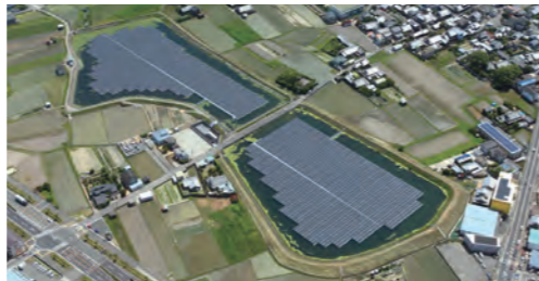
ため池を利用した太陽光発電所(大阪府泉南市)
