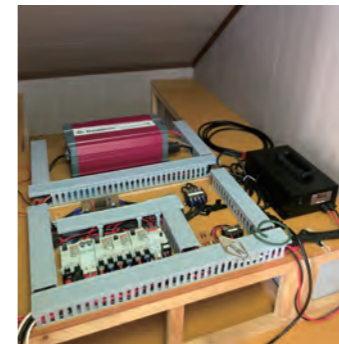
内部の蓄電ユニット
