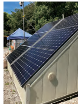
蓄電ユニット組み込み型の太陽光発電装置
