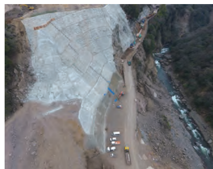
ライト工業は斜面崩壊した阿蘇長陽大橋と戸下大橋(写真)ののり面を含む「長陽大橋ルート」の復旧工事を担った
