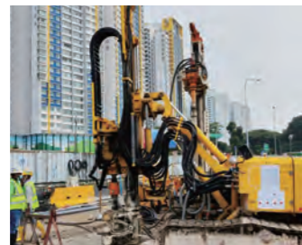
シンガポール ノースサウスコリドー高速道路N109A(地盤改良)
