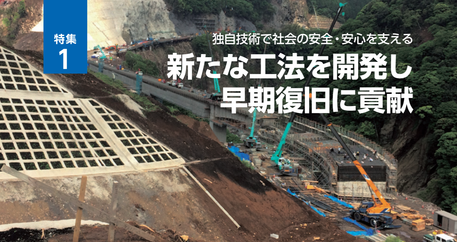
復旧工事が進む阿蘇長陽大橋（写真手前）と戸下大橋（写真奥）
