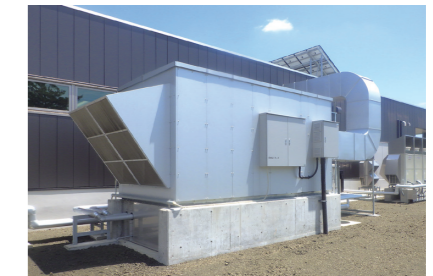
高効率ヒートポンプ式外調機
