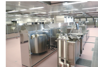
天井換気システム(写真上部)を備えた調理室
