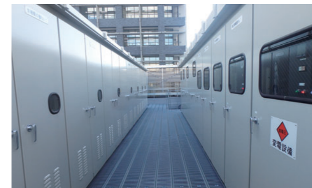
受変電設備は、電気を安定供給するために必要な建物の心臓部です。休むことなく安全に稼働する設備を提供します。
