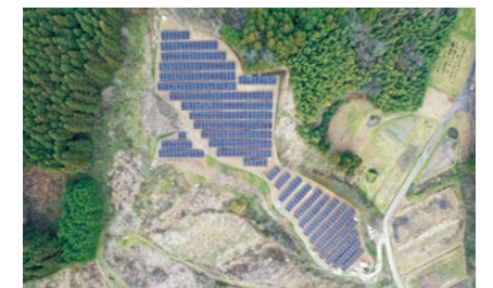
福島県田村市の太陽光発電設備
