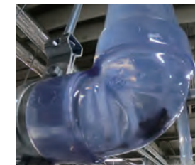
配管内模擬異物除去に最適な流速の実証状況
