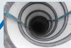
写真1 杭内の採熱チューブ
