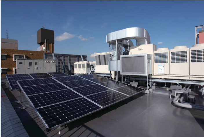
屋上の設備機器
