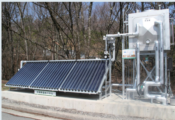
太陽熱温水パネル
