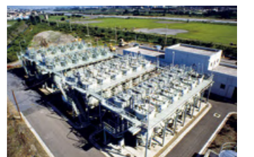
下水の高度処理施設
