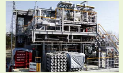
アンモニア合成実証試験装置
