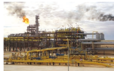
ソナトラク社向けガス集積・分離プラント 完工:2013年
