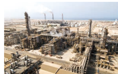
ペトロ・ラービグ社向け(サウジアラムコ社と住友化学 社の合併)石油精製・石油化学統合コンプレックス 完工:2008年
