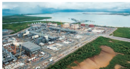
インベックス社向けLNGプラント 完工:2018年(予定)
