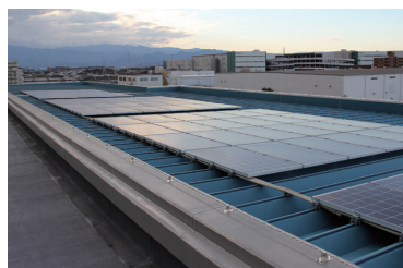
屋上に設置されている太陽光パネル
