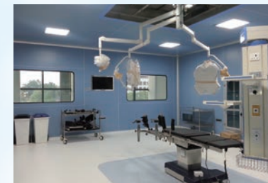
クリーンパネルによる施工施設(壁・天井・窓・ドア等)
