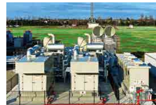
株式会社大塚製薬工場 富山工場 コージェネレーション設備 【電気・空調設備工事】
