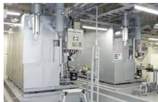
ガス焚き吸収式冷水機
