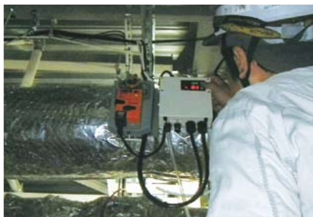
室圧制御ダンパー
