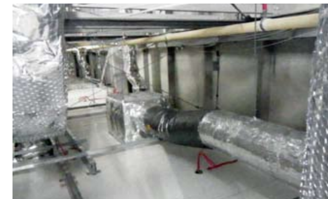
天井内クリーンパネル上メンテナンス通路
