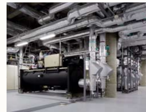
熱源機械室(インバータターボ冷凍機)
