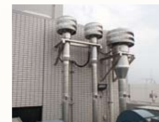
薬品排気系ベンチレーターファン
