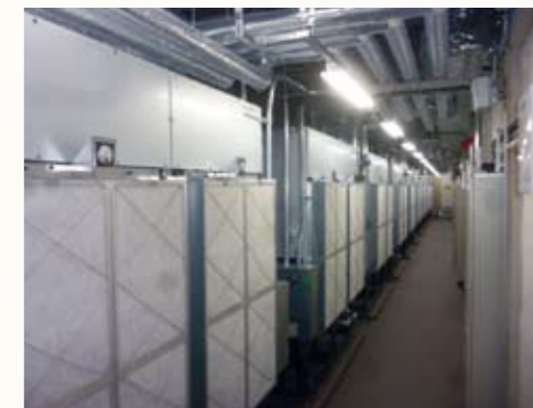
空調機械室(床吹き出し空調機)
