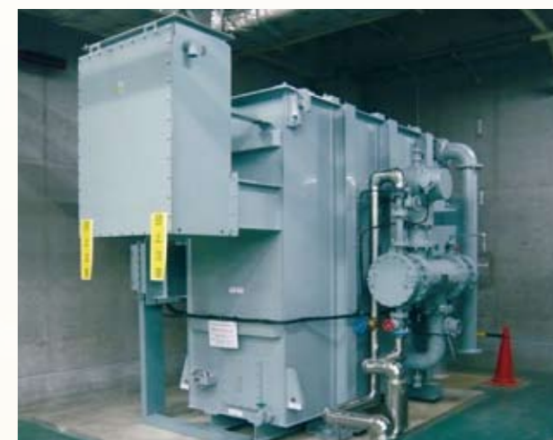
No.3特高トランス(据付状況)
