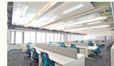
輻射パネルと照明
