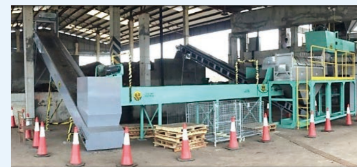
スリランカ西部州 都市ごみ再資源化施設の普及・実証事業における実証プラント
