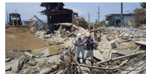
2018年 西日本豪雨被災現場調査
