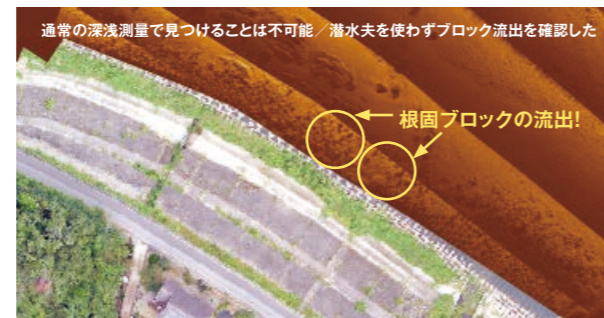
河川構造物の点検(根固ブロックの流出状況の音響画像)
