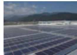
朝日工場 太陽光発電パネル
