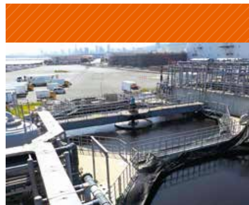
神戸工場内の排水処理施設
