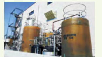
明治チューインガム(株)のメタン発酵処理施設
